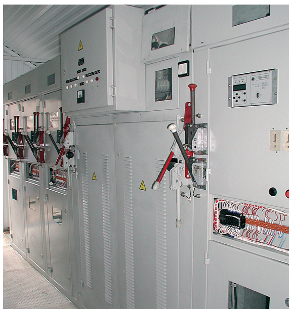
Рис. 15. Системы безударного пуска в блок-боксе
